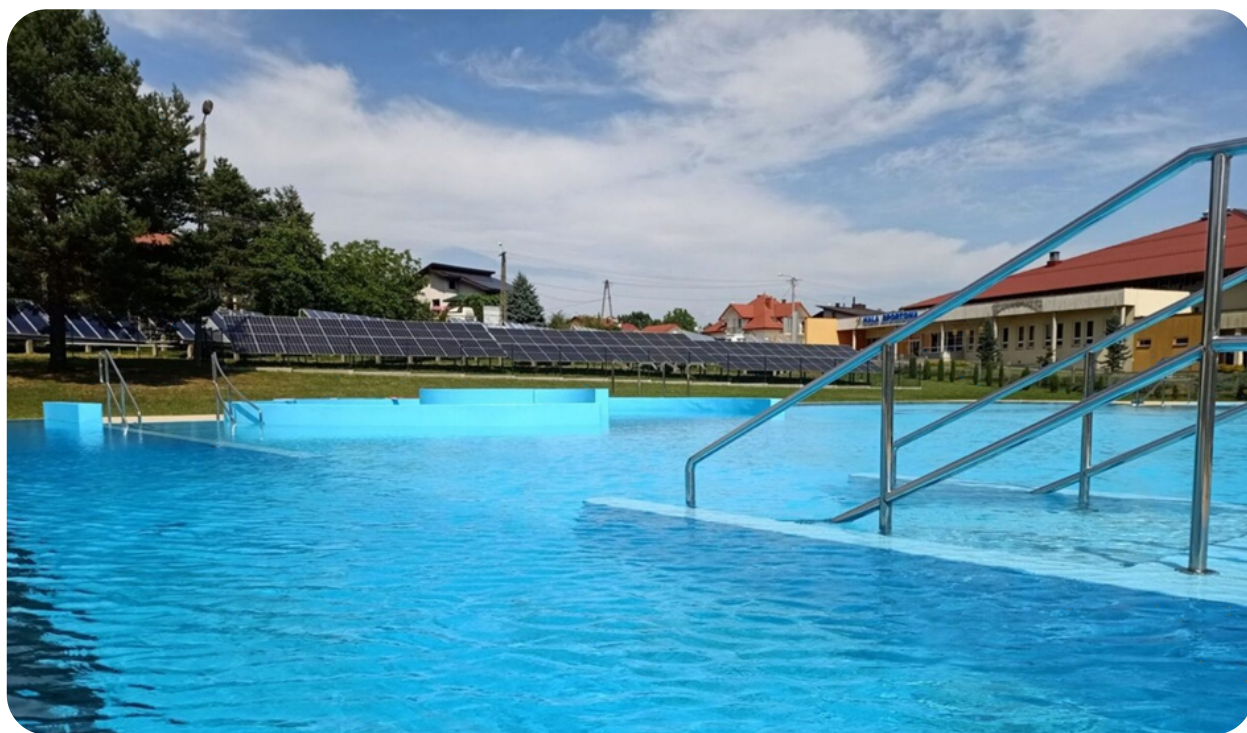
Instalacja fotowoltaiczna przy odkrytym basenie (fot. Dawid Drwal | TEMI)
