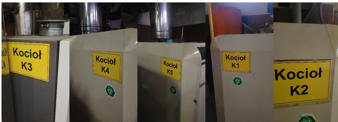
Rys. 21. Kotły gazowe Teatru (źródło własne).
